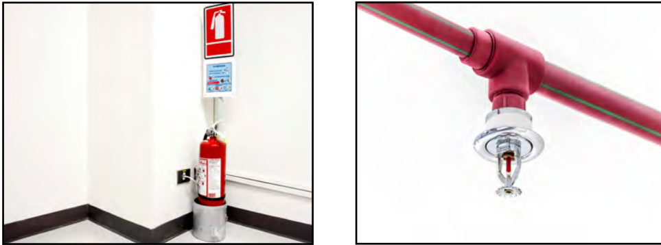
Görsel 5.22: Yangın tüpü ve depo yağmurlama sistemi
