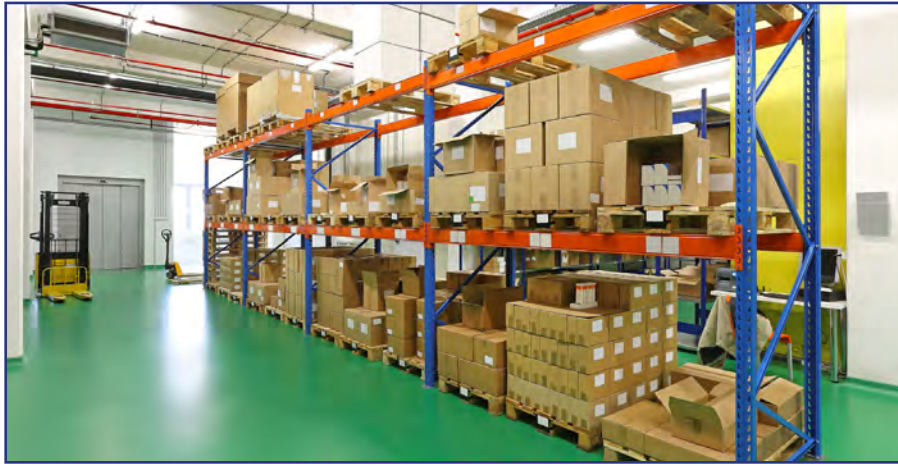
Görsel 5.18: Depo havalandırma sistemleri
