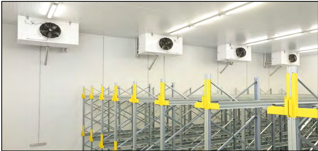
Görsel 3.14: Soğuk hava deposu
