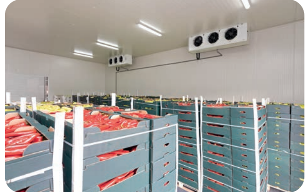
Görsel 2.19: Soğuk hava deposu
