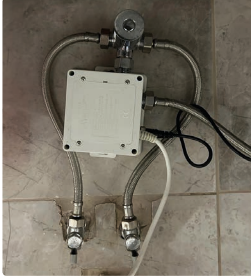
Görsel 6.13: Fotoselli batarya kontrol ünitesi
