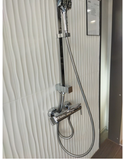
Görsel 5.13: Montajı yapılmış banyo bataryası
