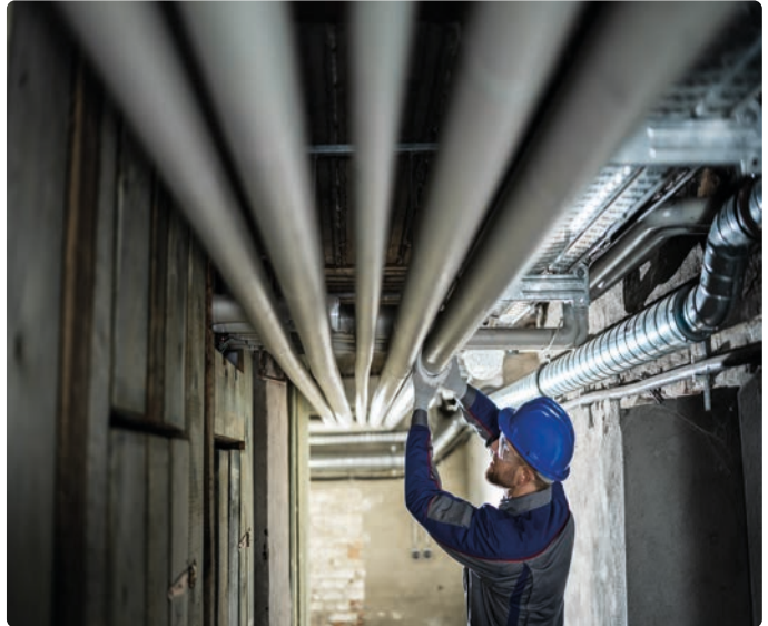
Görsel 4.2: Yatayda döşenmiş PVC boru
