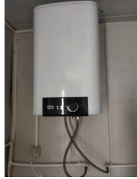
Görsel 7.5: Bağlantıları yapılmış termosifon
