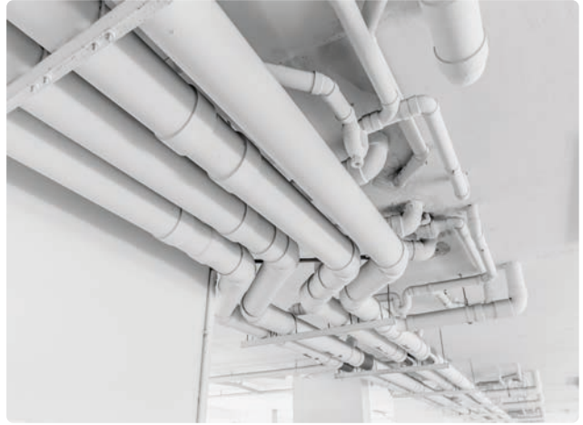
Görsel 4.6: Pis su tesisatı
