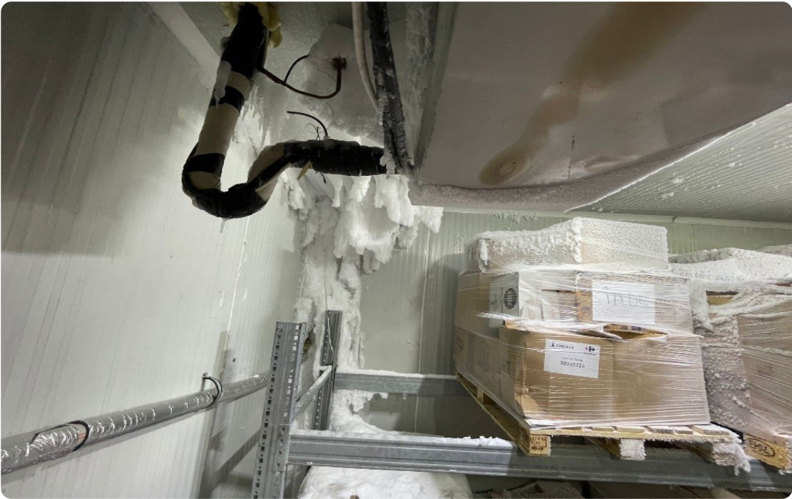
Görsel 4.1: Soğuk hava deposunda oluşan karlanmalar
