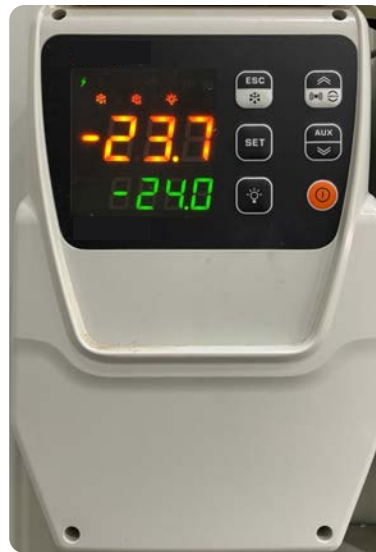
Görsel 4.3: Soğutma cihazı kontrol paneli
