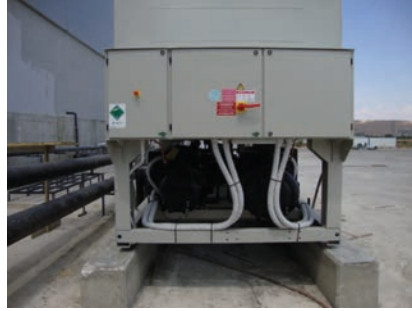
Görsel 9.1: Yüksek kaide üzerine konumlanmış chiller
