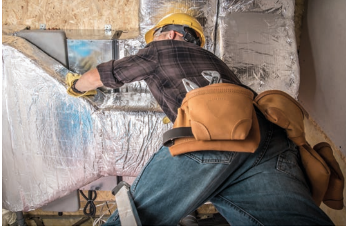
Görsel 5.17: Havalandırma kanalının yalıtım kontrolleri ve bakımı
