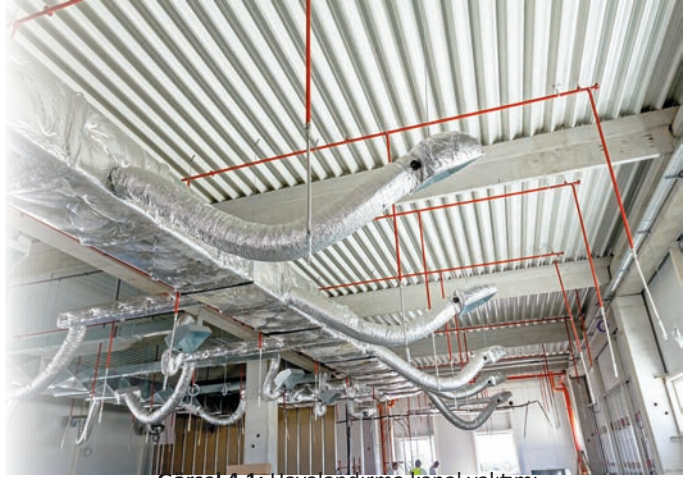
Görsel 4.1: Havalandırma kanal yalıtımı
