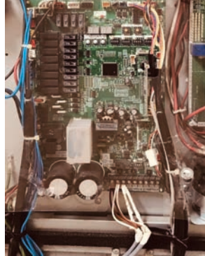
Görsel 12.8: Değişken debili soğutucu dış ünite sinyal kablo bağlantıları
