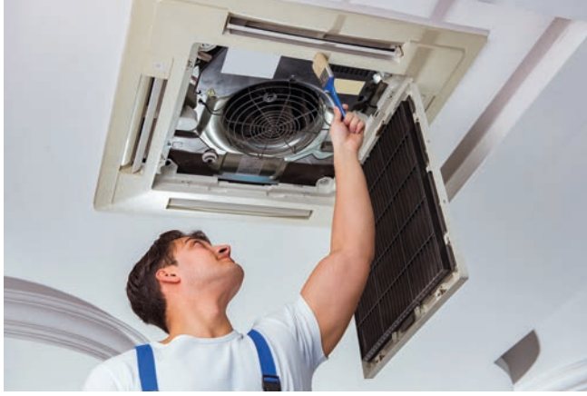
Görsel 5.9: Havalandırma sistemi fan kontrolü
