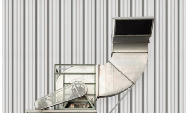
Görsel 5.5: Havalandırma kanalında fan düzeneği
