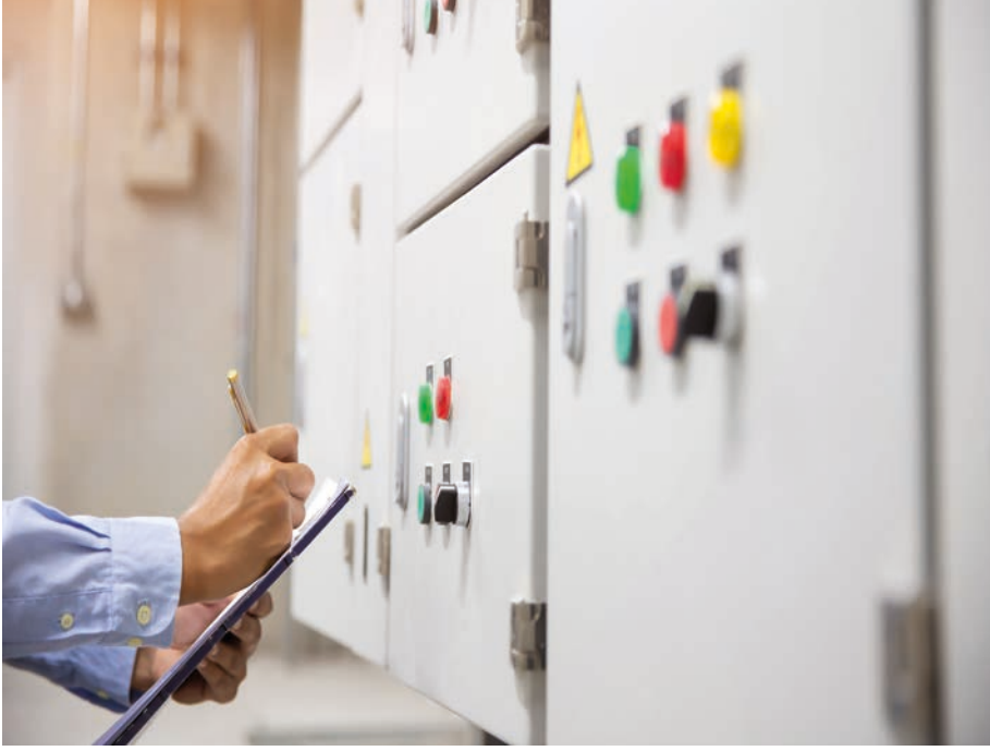
Görsel 7.6: Elektrik panosu genel kontrolü
