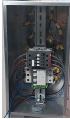
Görsel 11.1: Elektriksel bağlantı
