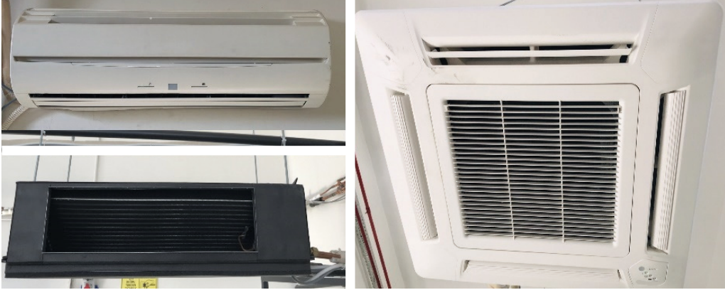
Görsel 12.11: Montajı yapılmış değişken debili soğutucu iç üniteleri
