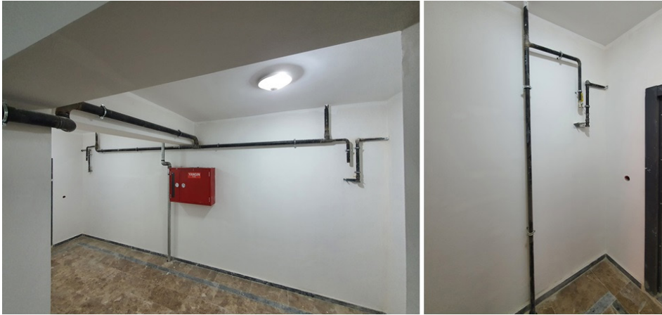
Görsel 3.12: Doğal gaz kolon tesisatı
