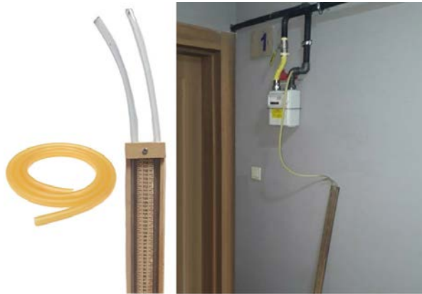
Görsel 3.32: U manometre ile sızdırmazlık testi
