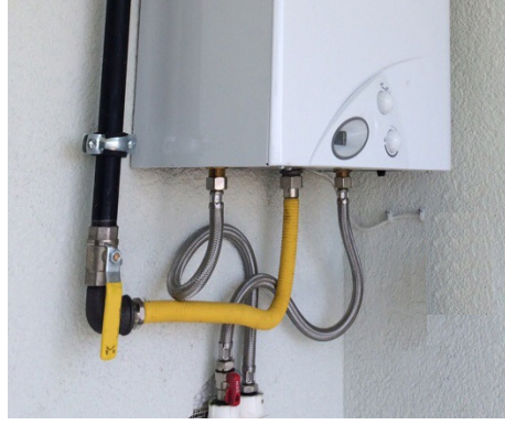
Görsel 4.19: Şofbenin doğal gaz bağlantısı
