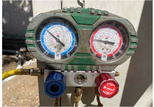
Görsel 7.27: Soğutma gazının sistemde dolaşmaması
