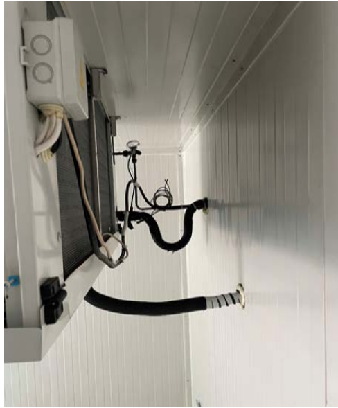
Görsel 7.13: Evaporatör montajı
