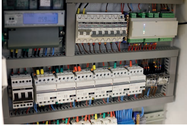
Görsel 8.23: Soğuk oda elektrik panosu
