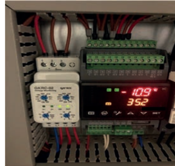
Görsel 9.12: Soğuk oda kontrolörü pano içi bağlantısı
