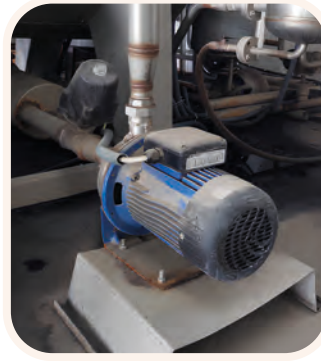
Görsel 4.3: Sirkülasyon pompası
