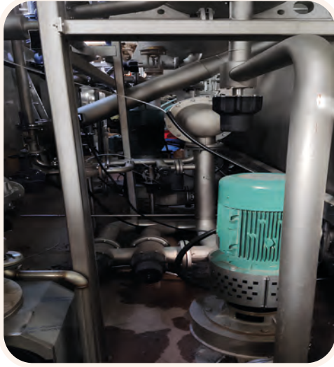
Görsel 2.18: Sirkülasyon pompası
