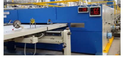
Görsel 6.11: Kamarlarda geçiş göstergesi
