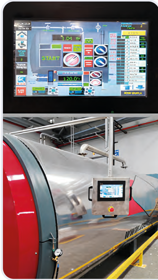
Görsel 9.7: Kontrol paneli (PLC)
