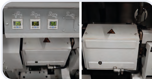
Görsel 4.7: Hava ve yağ kontrolü
