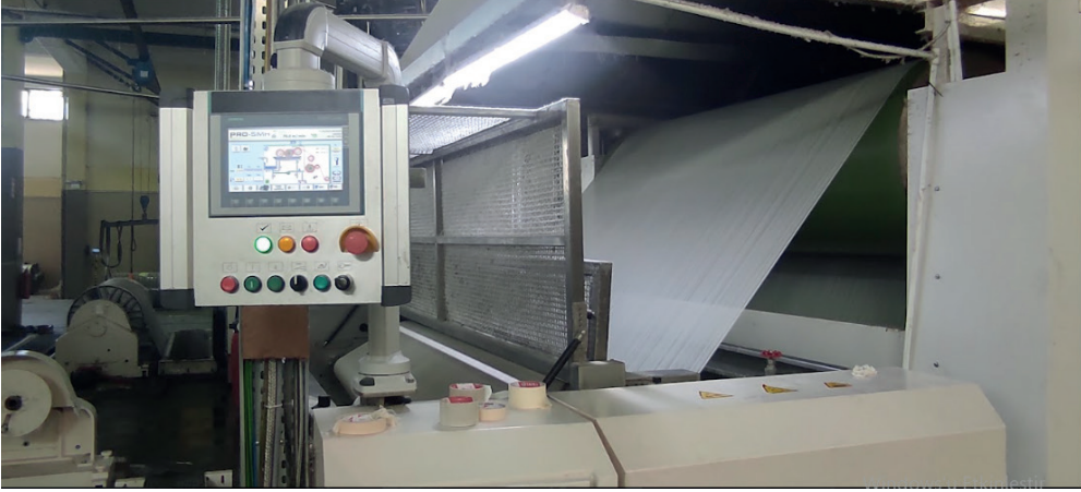
Görsel 2.32: Kontrol paneli ekranı
