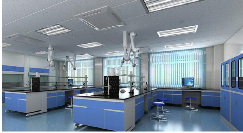
Görsel 1.17: Laboratuvar havalandırma sistemi
