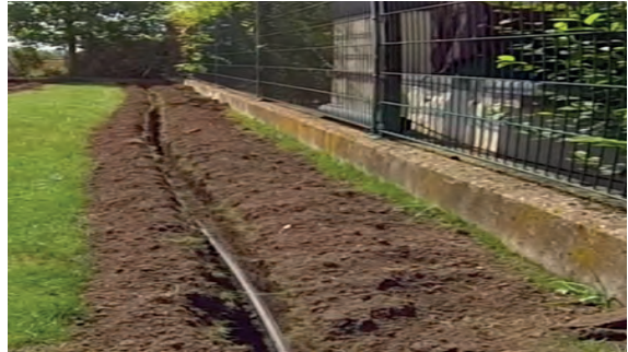
Görsel 5.78: Çim alan sulaması ana boru hattı
