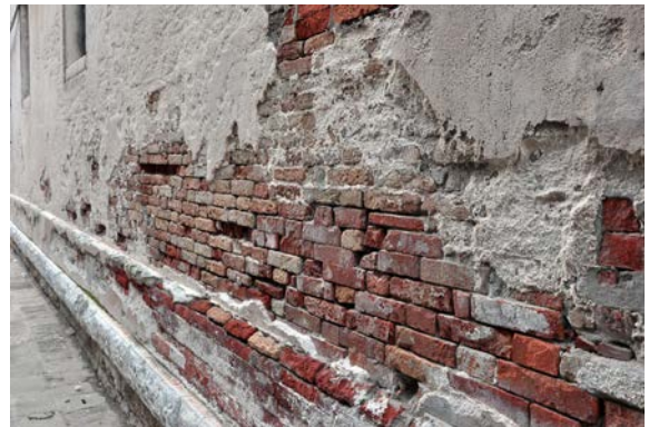
Görsel 1.53: Betondan parça kopması
