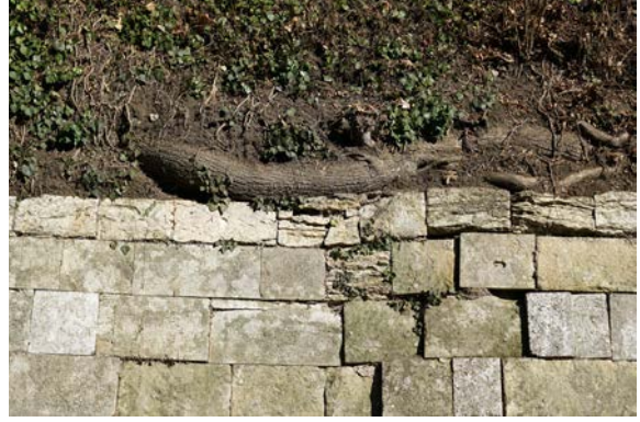
b) Taşların yanlış yerleştirilmesi
