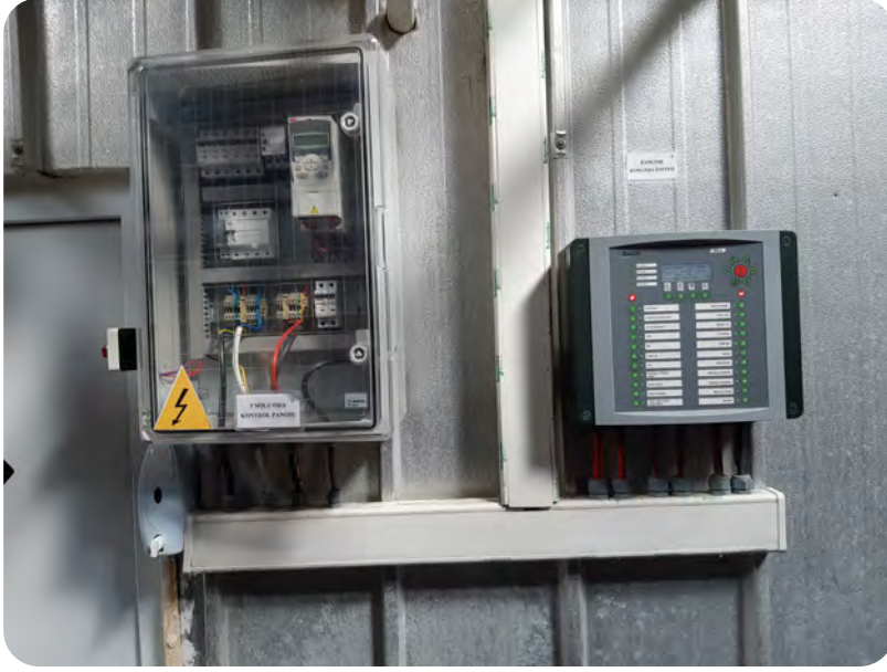
Görsel 1.43: Havalandırma takip panosu
