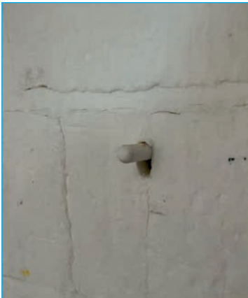
Görsel 5.19: Fırın içerisindeki termokupl
