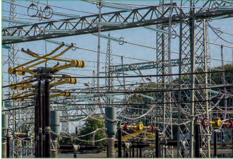
Görsel 4.9: Trafo merkezi
