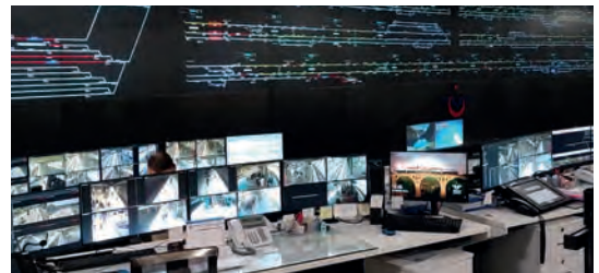
Görsel 3.4: Marmaray SCADA odası
