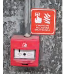
Görsel 5.11: Yangın alarm butonu
