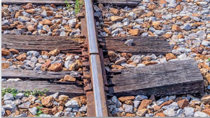
Görsel 12.3: Arızalı (çürümüş) ahşap travers
