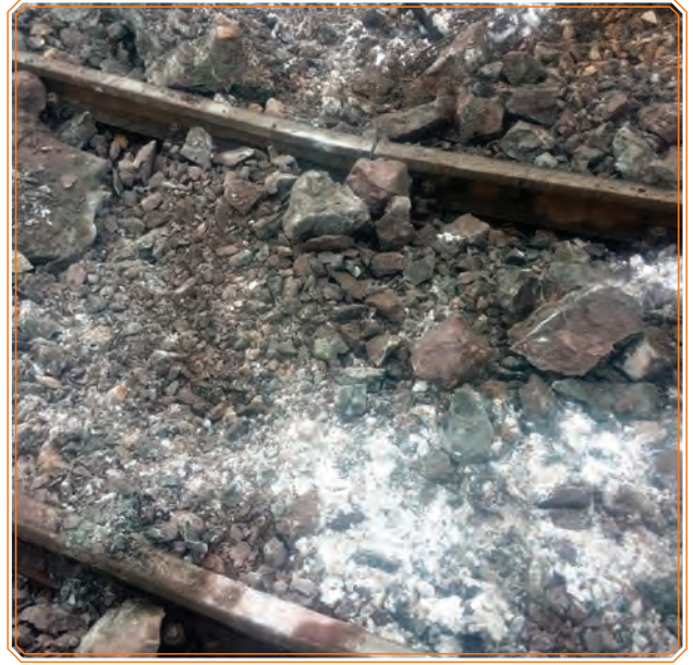
Görsel 5.16: Taş düşmesinden kaynaklı üstyapıda görülen deformasyonlar
