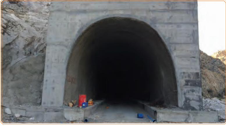
Görsel 2.23: Tünel yapımı esnasında bırakılan drenaj boruları
