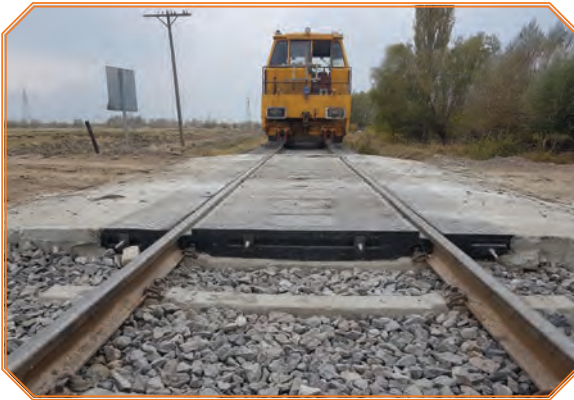
Görsel 4.11: Kauçuk kaplamalı hemzemin geçit
