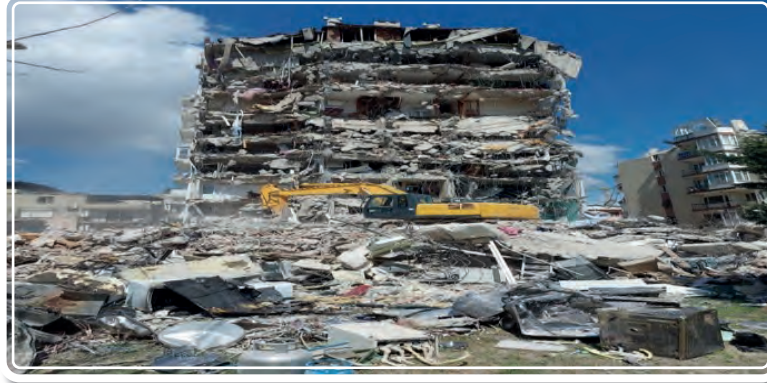
Görsel 2.16: Depremde hasar görmüş bir bina
