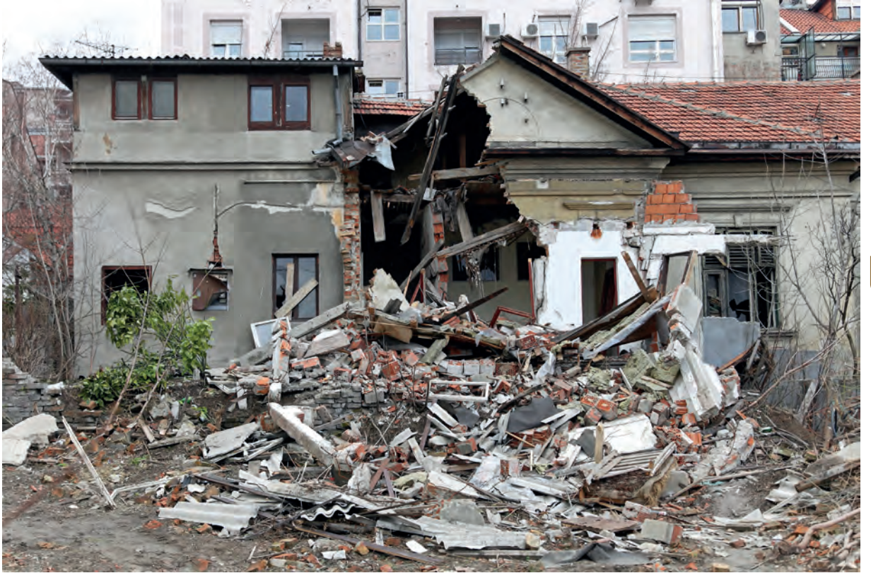
Görsel 3.2: Depremde oluşan hasar
