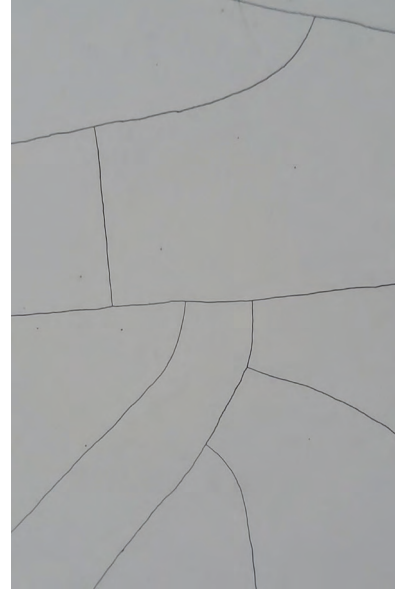
Görsel 3.11: Boya-vernik çatlakları
