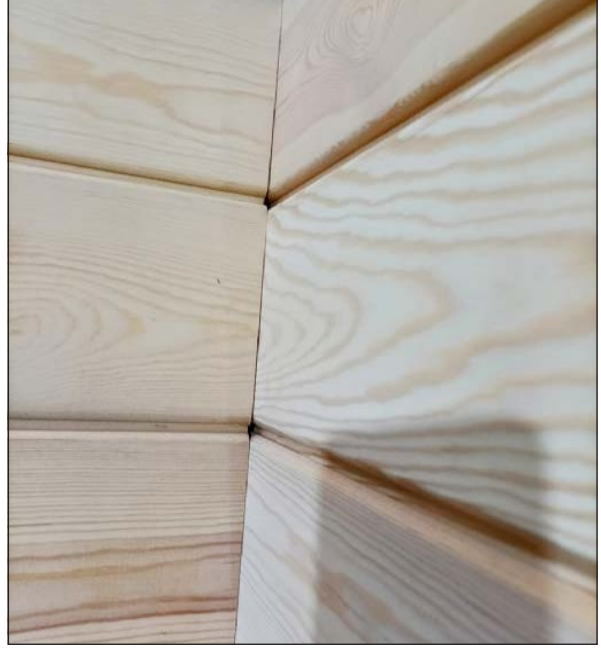
Görsel 4.47: Derz boşluğu görünen kaplama yüzeyi
