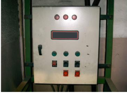
Görsel 8.3: Dağıtım panosu
