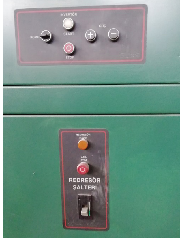
Görsel 8.5: İvertör start-stop düğmesi
