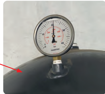
Görsel 2.54: Gaz kontrolleri
