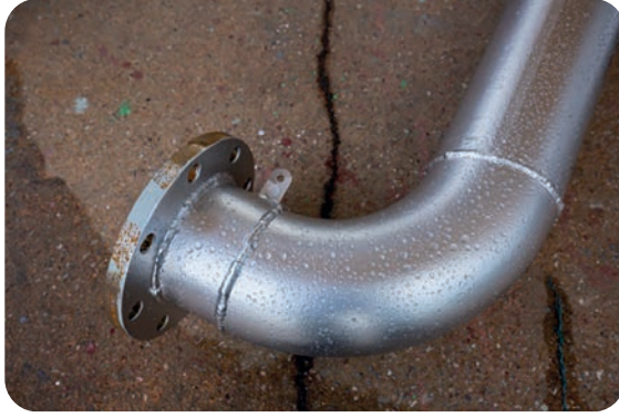
Görsel 2.16: Kaynakla birleştirilmiş flanş
