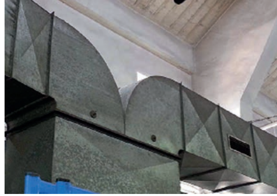
Görsel 4.1: Havalandırma sistemleri
