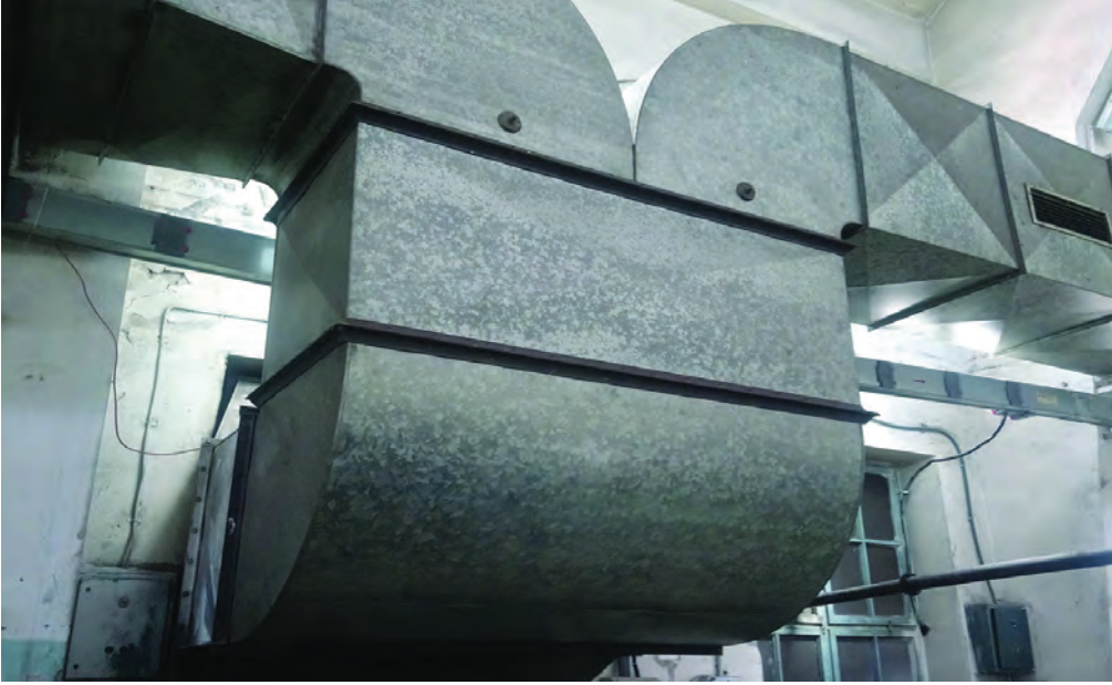
Görsel 7.1: Havalandırma sistemi
