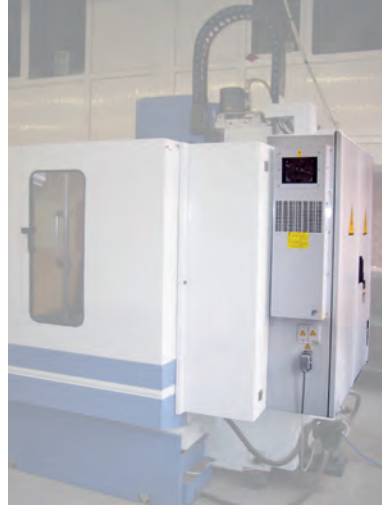
Görsel 1.43: CNC freze tezgâhı elektrik panosu
