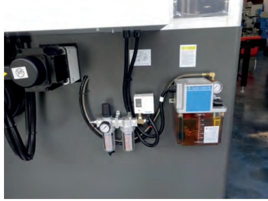
Görsel 1.42: Yağlama ünitesi
