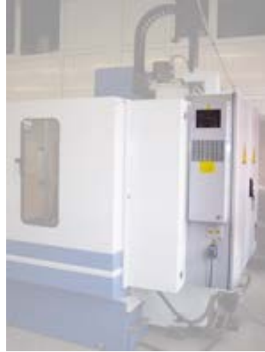
Görsel 6.8: CNC freze tezgâhı elektrik panosu
