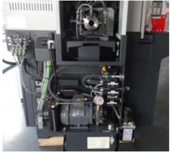
Görsel 1.9: Yağlama ünitesi
