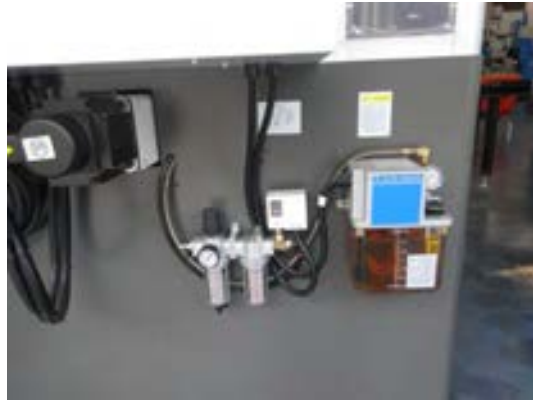
Görsel 6.7: Yağlama ünitesi
