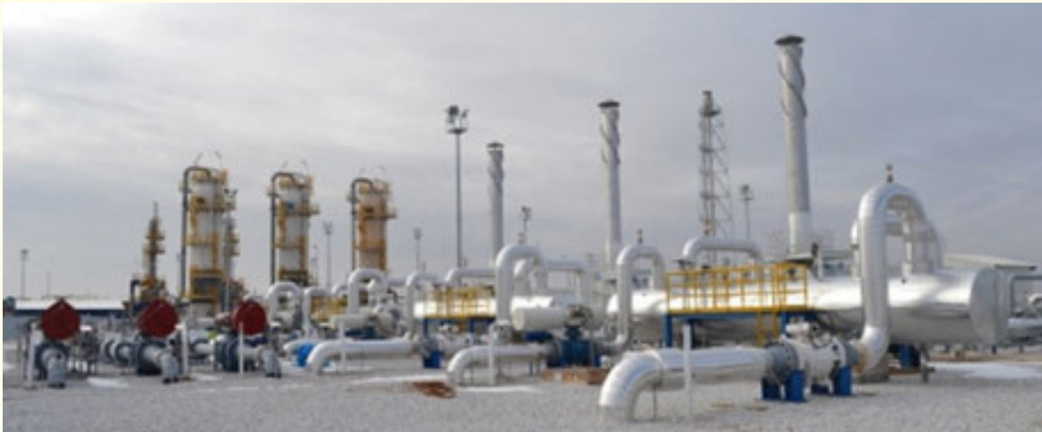
Görsel 7.12: Doğal gaz depolama tesisi
