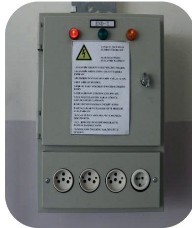
Görsel 1.15: Elektrik panosu
