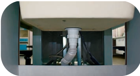
Görsel 1.14: Atık su tesisatı
