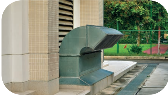
Görsel 1. 18: Havalandırma sistemi
