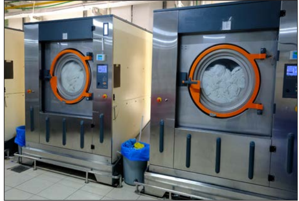
Görsel 5.1: Endüstriyel makinelerden oluşan çamaşırhane
