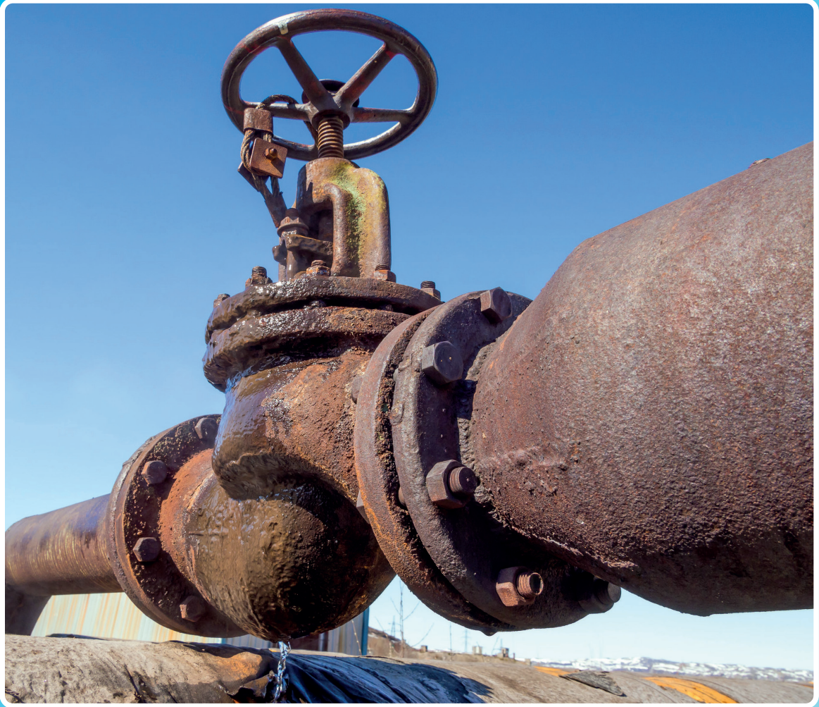
Petrol boru hattındaki korozyon
