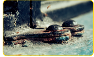
Görsel 1.5: İki farklı metal arasında oluşan galvanik korozyon
