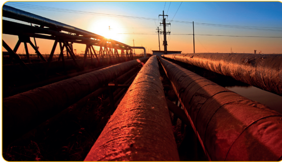
Görsel 2.3: Boru hattı
