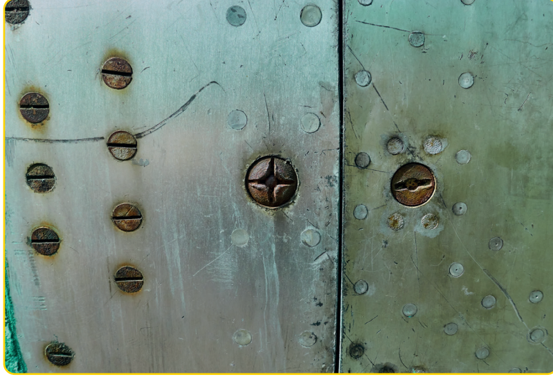
Görsel 1.9: Hatalı malzeme seçimi nedeniyle oluşan korozyon
