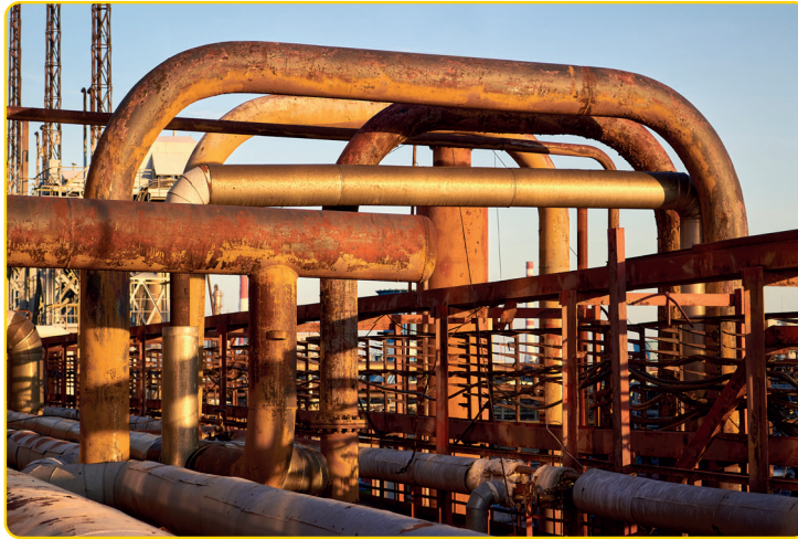
Görsel 1.17: Rafineride gaz toplayıcı çelik boruların korozyonu
