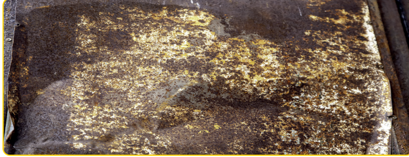
Görsel 1.16: Metal yüzeyde korozyon
