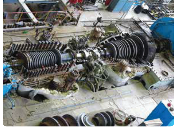
Görsel 9.14: Bakımdaki buhar türbini
