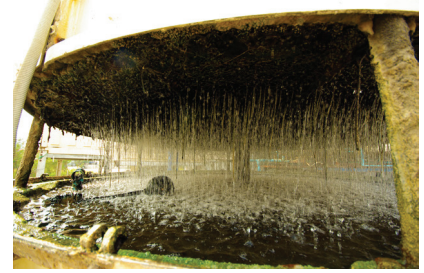
Görsel 6.2: Soğutma kulesinin içi
