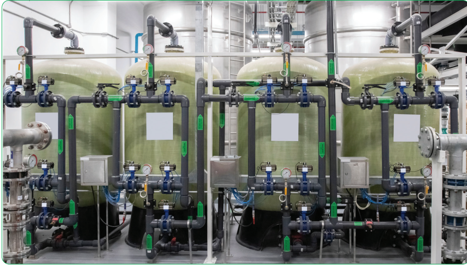
Görsel 7.9: Su yumuşatma kontrolü
