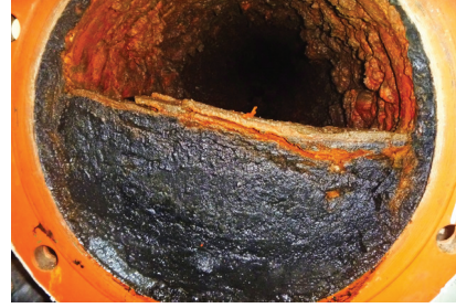
Görsel 6.5: Soğutma sisteminde kireç, çamur ve korozyon ürünlerinin tortulaşması
