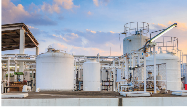
Görsel 4.3: Azot gazı tesisi
