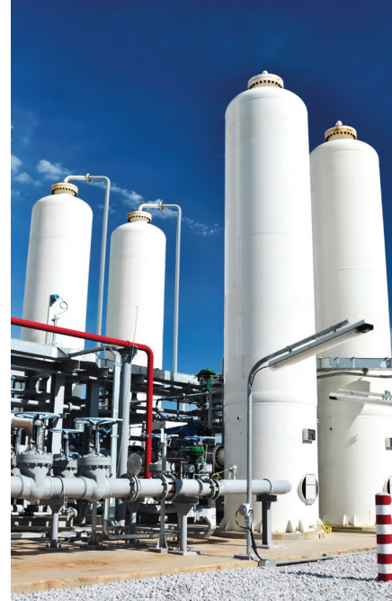
Görsel 4.4: Endüstriyel nitrojen tankları
