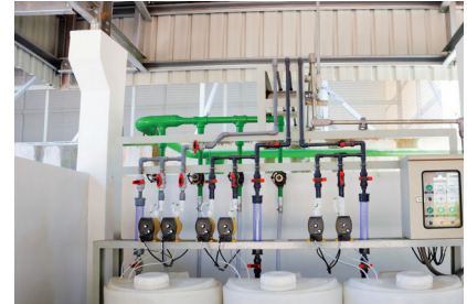
Görsel 6.6: Soğutma kulesi için kimyasal dozaj istasyonu
