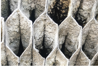
Görsel 6.4: Soğutma kulesinde kazan taşı
