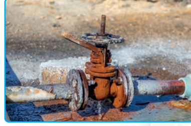
Görsel 2.5: Korozyon nedeniyle sızıntı yapan valf
