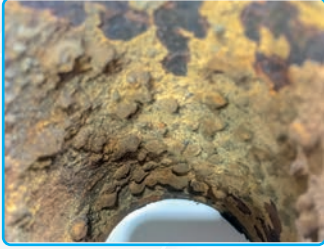
Görsel 1.22: Metal boru içerisinde erozyon korozyonu
