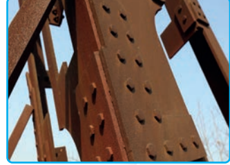
Görsel 1.17: Genel korozyona uğramış metal yapı
