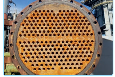
Görsel 3.3: Korozyona uğramış buhar kazanı kızdırıcısı
