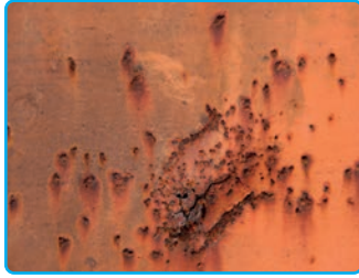
Görsel 1.18: Çukur korozyonu
