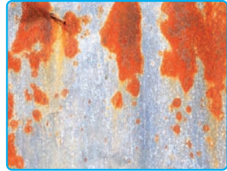
Görsel 1.19: Galvanik korozyon
