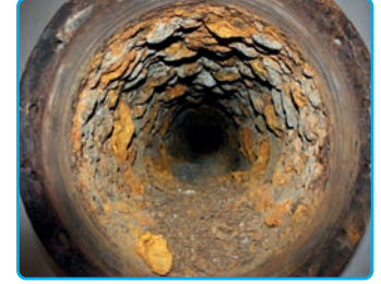
Görsel 3.16: Erozyon korozyonuna uğramış metal boru
