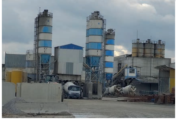
Görsel 3.21.b: Beton santrali
