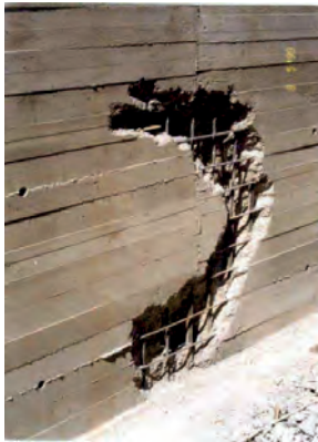
Görsel 2.18: Bünyesinde boşluk oluşmuş beton
