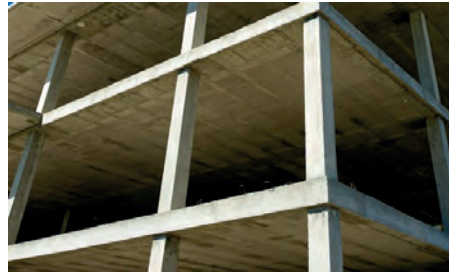
Görsel 2.2: Sertleşmiş beton
