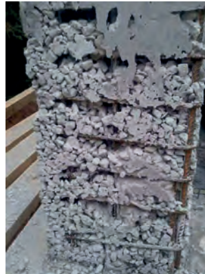
Görsel 2.19: Segregasyon meydana gelmiş beton
