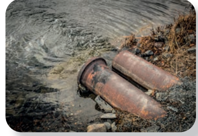
Görsel 1.59: Kanalizasyonun suya karışması
