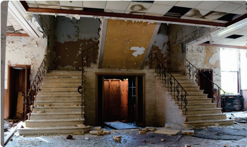
Görsel 2.4: Binalarda yapısal hasarlar
