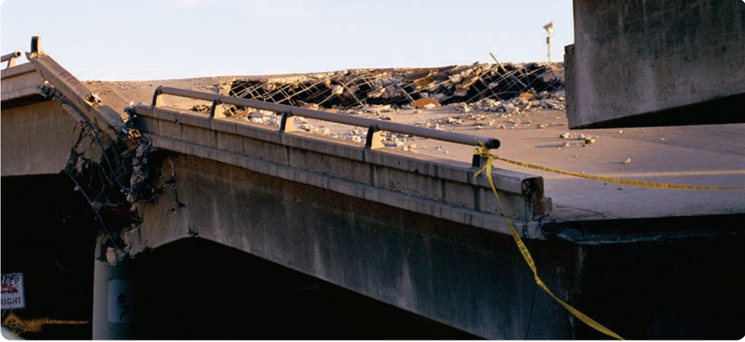
Görsel 7.5: Depremde çökmüş bir köprü
