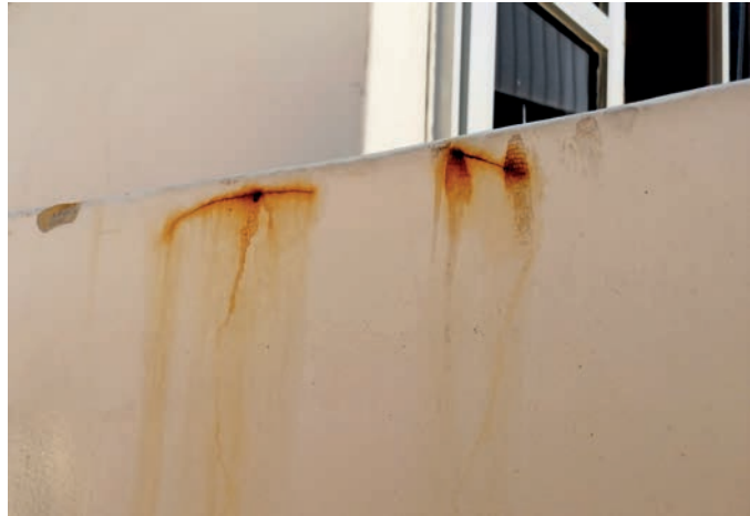
Görsel 1.7: Korozyon (paslanma)
