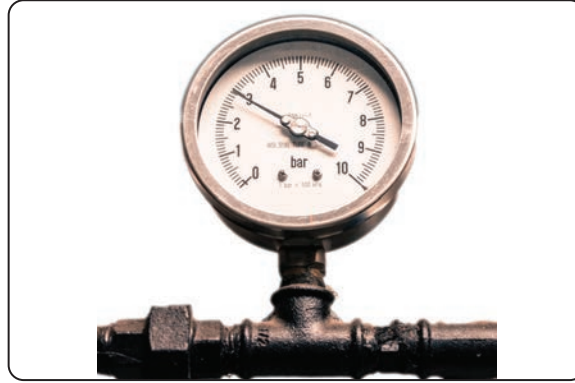
Görsel 5.9: Boru devresi üzerinde manometre
