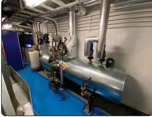
Görsel 2.45: Isıtıcı borularının izolasyonu
