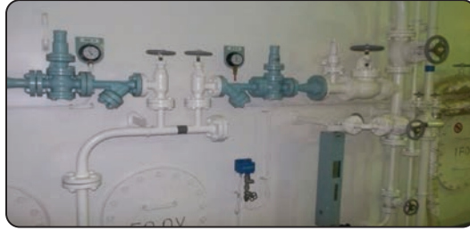
Görsel 2.21: Kontrol hava bağlantıları
