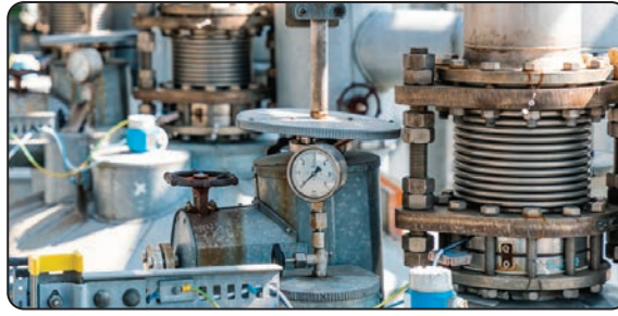
Görsel 1.45: Metal kompansatör uygulaması
