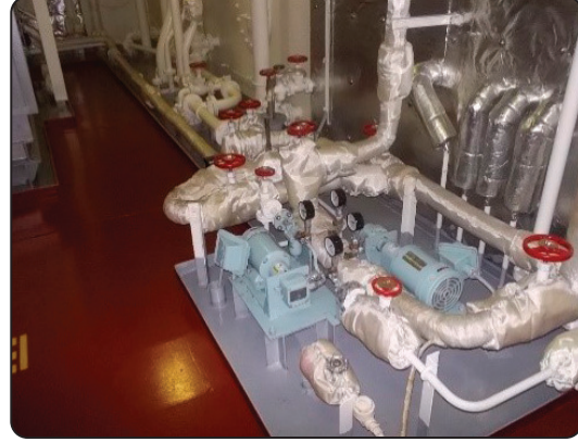
Görsel 2.46: Yakıt borularının izolasyonu
