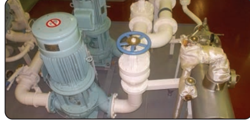
Görsel 2.29: Soğutma pompalarının bağlantıları
