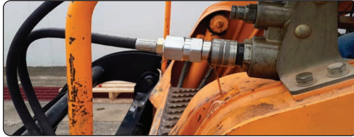
Görsel 3.28: Bağlantı noktasında hidrolik yağ kaçağı
