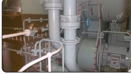
Görsel 2.30: Ana makine soğutma suyu giriş bağlantıları
