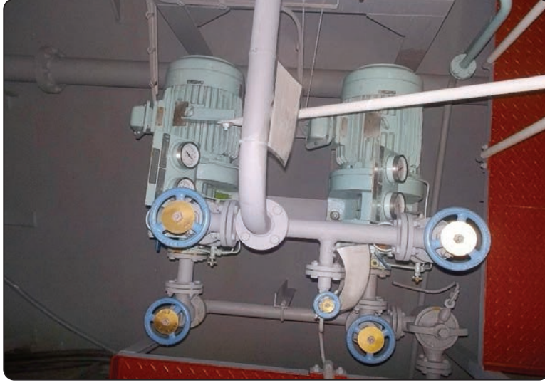
Görsel 2.36: Hidrofor pompaları
