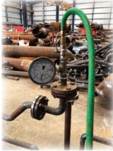
Görsel 5.15: Manometre ile basınç kontrolü
