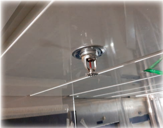
Görsel 5.20: Yangın tesisatı sprinkleri
