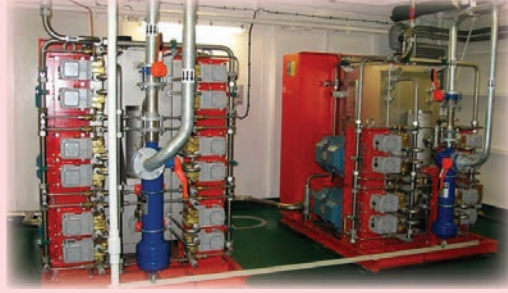
Görsel 5.1: Gemi yangın tesisatı pompası
