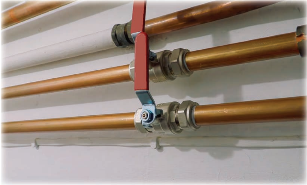
Görsel 3.1: Bakır boru tesisatı
