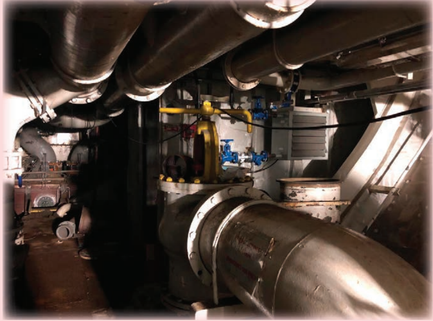
Görsel 8.1: Balast tesisatı
