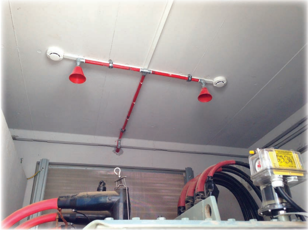
Görsel 5.24: Karbondioksit gazlı yangın söndürme sistemi
