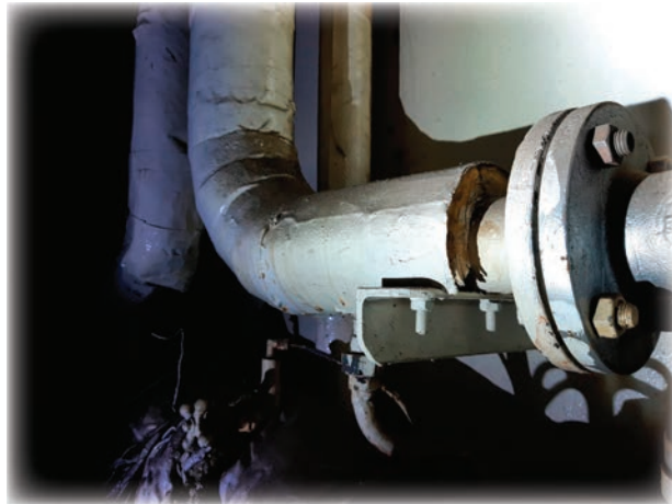
Görsel 10.14: İzolasyonu yapılmış boru
