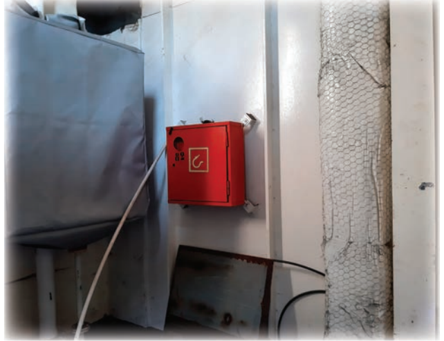
Görsel 5.19: Yangın tesisatı dolabı
