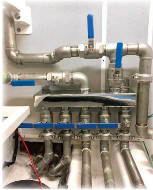
Görsel 6.1: Temiz su tesisatı
