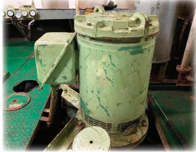
Görsel 5.21: Yangın tesisatı pompası
