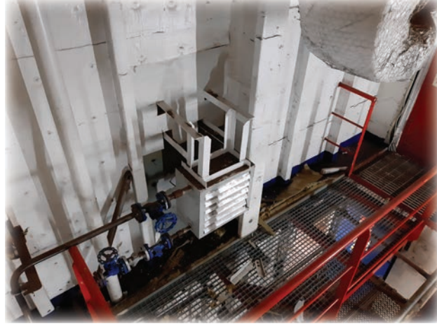
Görsel 7.15: Merdiven boşluğuna yerleştirilen fan coil
