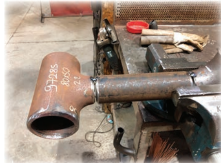
Görsel 5.12: Ana kolon hattı puntalanmış boru devresi
