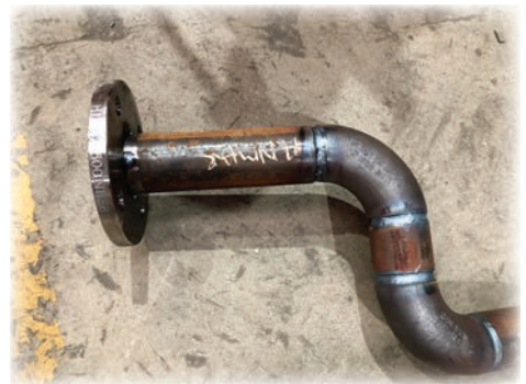
Görsel 6.20: İmalatı tamamlanmış atık su tesisatı devresi
