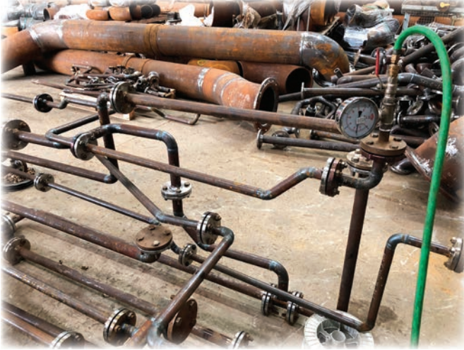
Görsel 10.3: Basınçlı hava tesisatı sızdırmazlık testi
