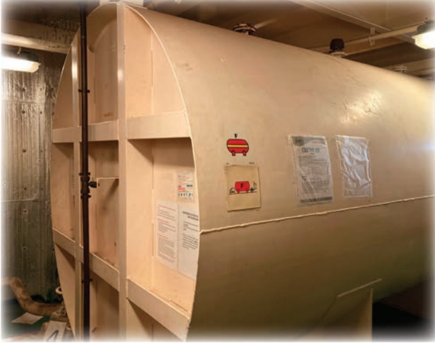
Görsel 5.18: Yangın tesisatı tankı
