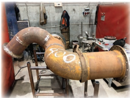
Görsel 8.5: İmalatı tamamlanmış balast tesisatı devresi
