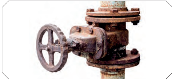
Görsel 2.81: Uniform korozyon
