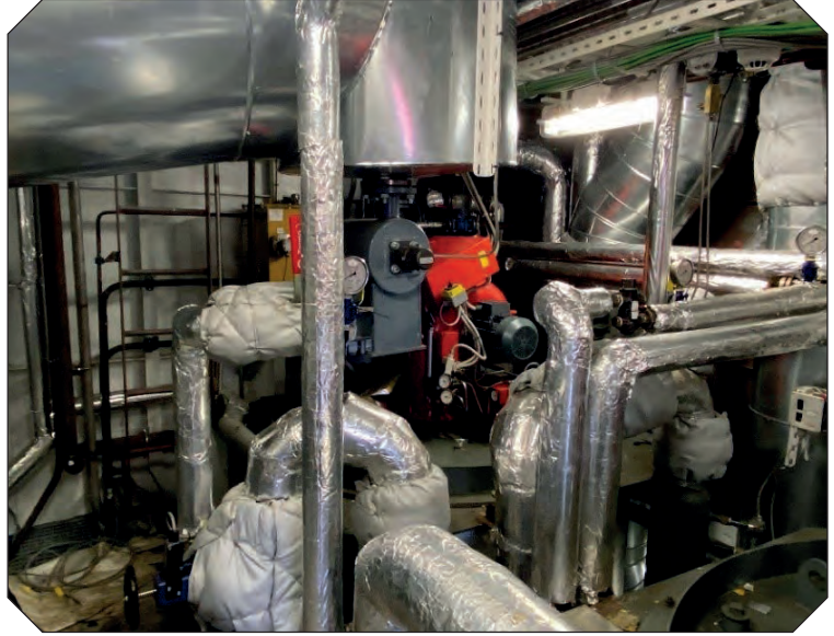
Görsel 1.9: Yalıtımı yapılmış buhar devreleri
