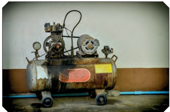
Görsel 4.120: Bakımları yapılmamış kompresör ve korozyona uğramış hava tankı
