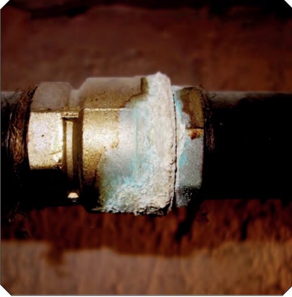
Görsel 2.84: Seçimli korozyon (çinkosuzlaşma)
