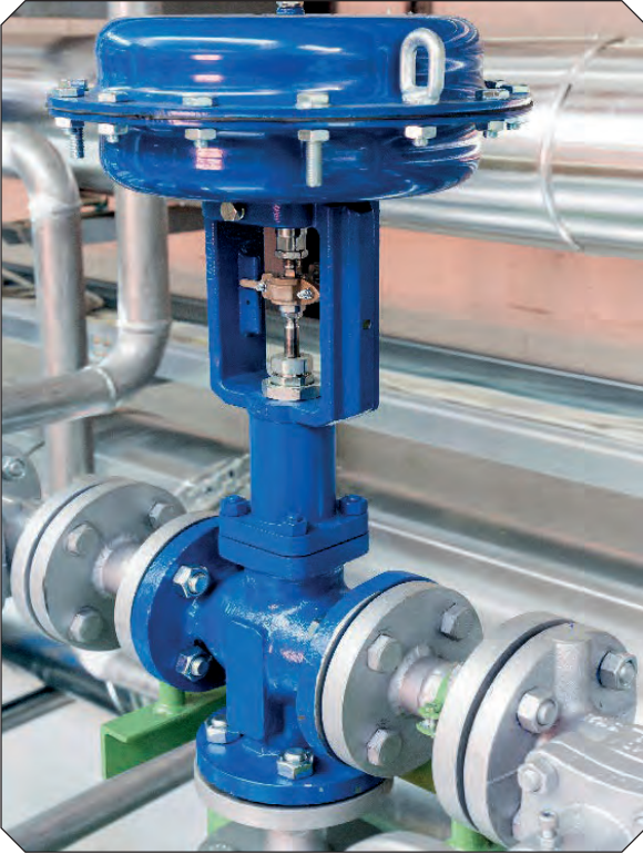
Görsel 2.76: Sıcaklık kontrol valfi
