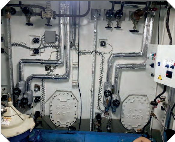
Görsel 1.7: Yakıt devrelerinin tank bağlantıları
