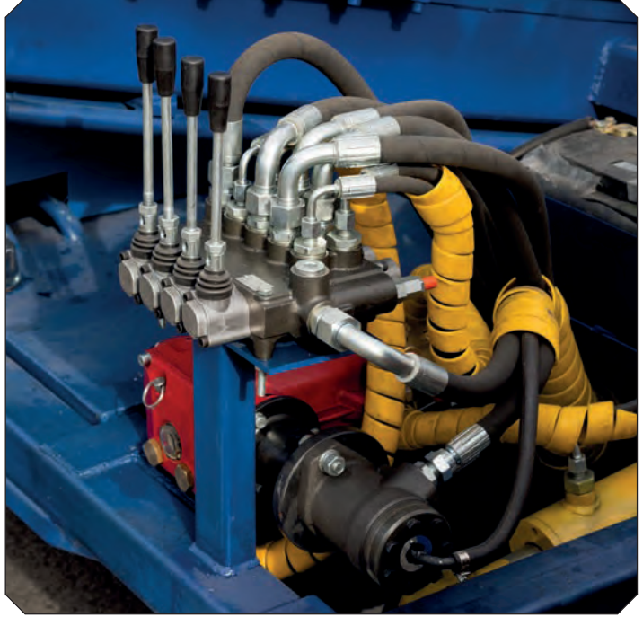
Görsel 4.42: Yüzey temizliği yapılarak yerine bağlanmış valf
