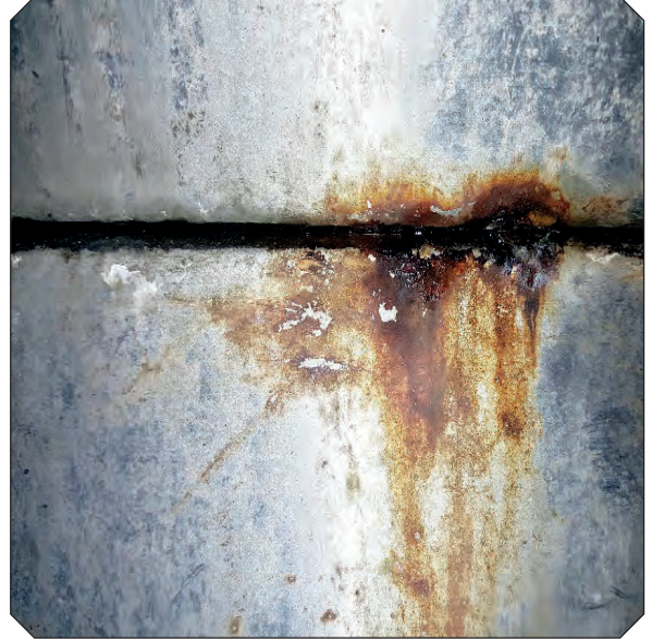
Görsel 2.85: Çatlak (aralık) Korozyonu
