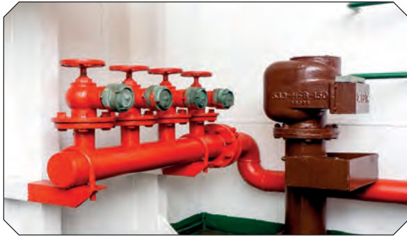
Görsel 1.3: Ana yangın hattının hidrantlara bağlantısı
