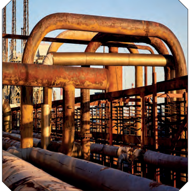
Görsel 1.18: Korozyona uğramış boru devreleri
