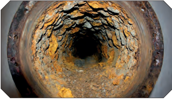
Görsel 1.19: Erozyona uğramış borunun iç yüzeyi
