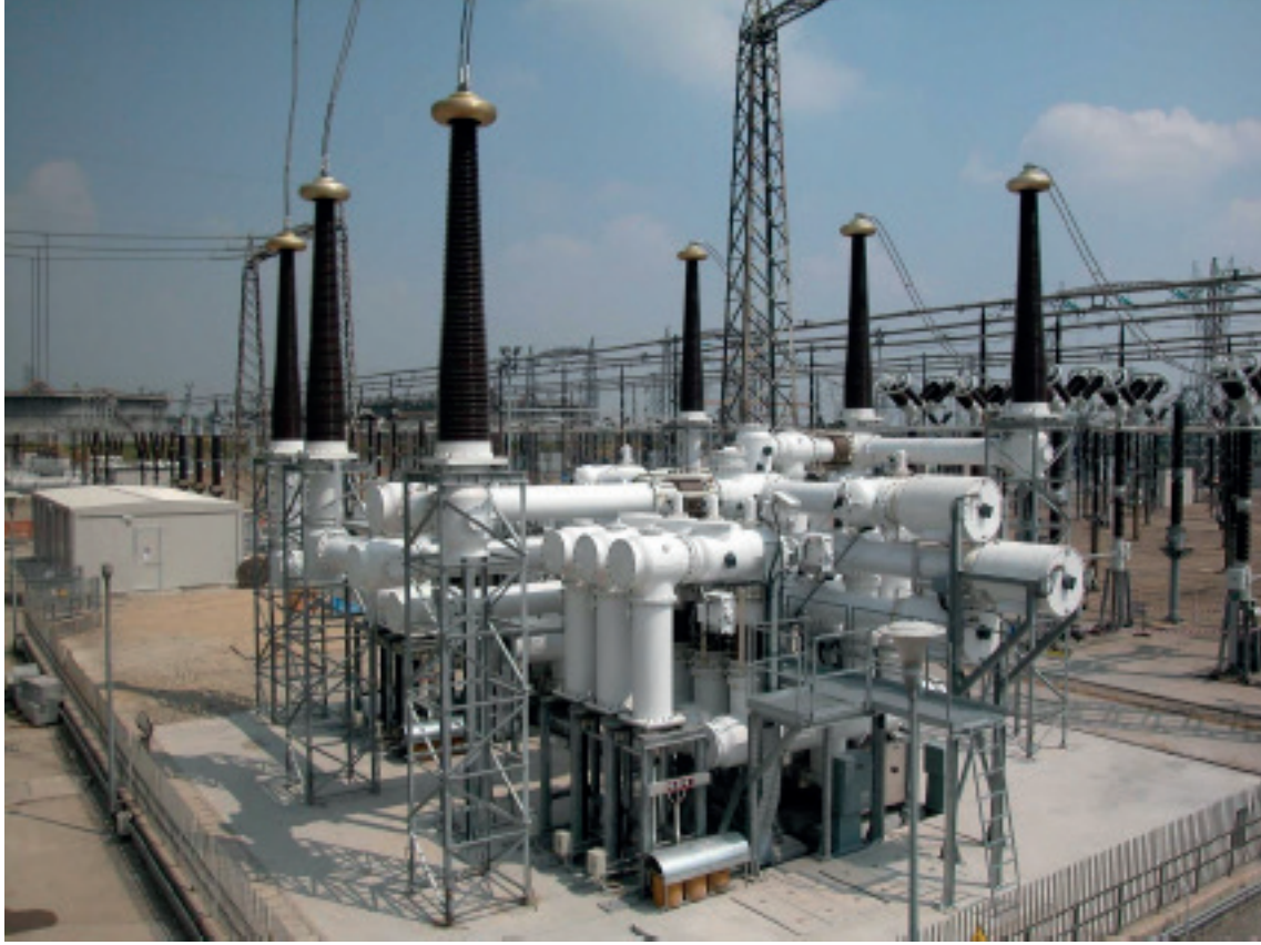
Görsel 2.5: Gaz izoleli şalt sahası
