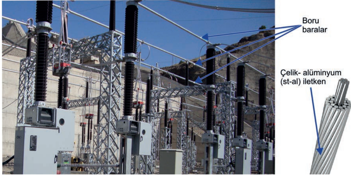
Görsel 2.27: Şalt sahasında boru bara ve çelik-alüminyum iletken bara
