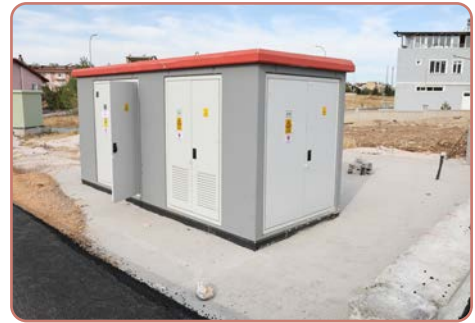
Görsel 1.3: Bina tipi trafo merkezi
