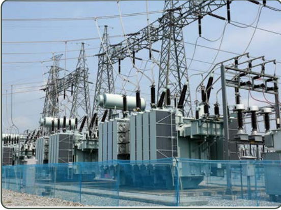
Görsel 4.7: Şalt sahası
