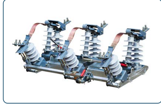
Görsel 3.11: Ayırıcı izolatör ve bıçakları
