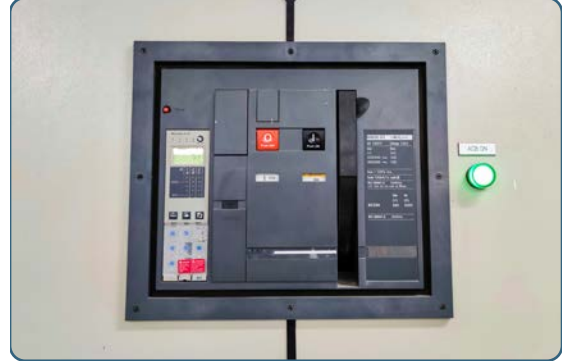
Görsel 3.12: Kesici açma ve kapama kontrol ünitesi
