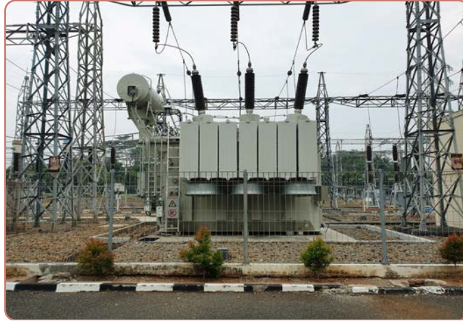
Görsel 1.2: Açık yer tipi trafo merkezi
