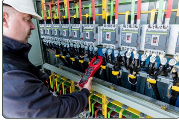
Görsel 4.5: Termik manyetik şalterlerin pano içerisindeki bağlantıları
