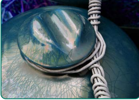
Görsel 5.46: İzolatöre iletken bağlantısı
