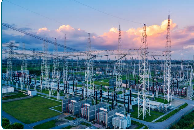
Görsel 7.1: Yüksek gerilim tesisi
