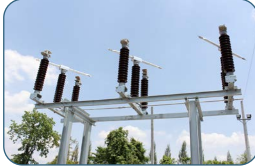
Görsel 3.5: Döner izolatörlü ayırıcı
