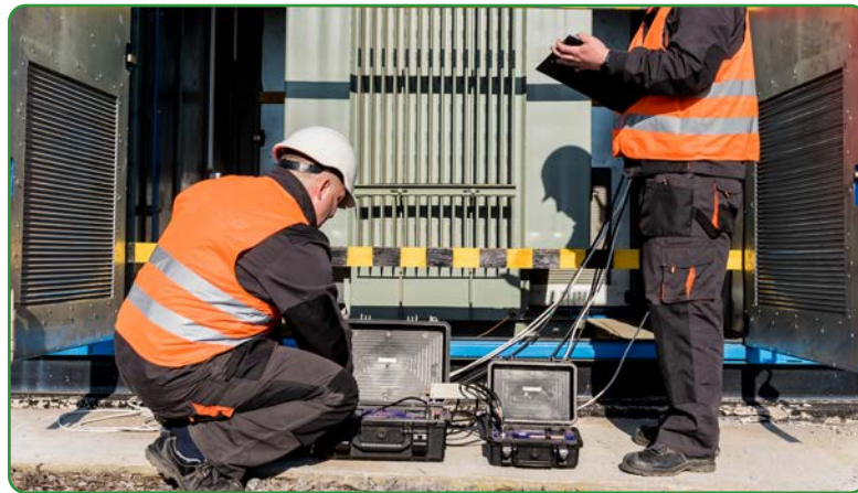
Görsel 2.8: Trafo bakımı
