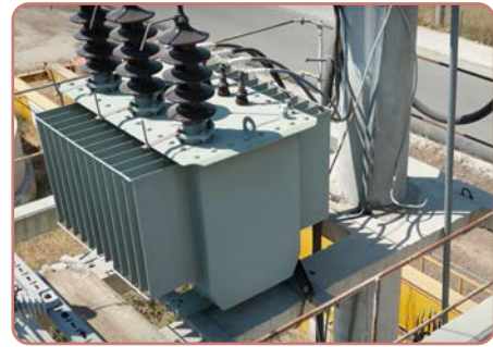
Görsel 1.1: Direk tipi trafo merkezi
