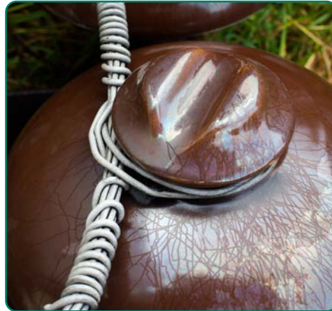
Görsel 5.45: İzolatöre iletken bağlantısı
