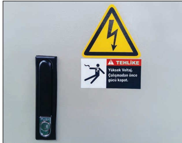
Görsel 1.1: Elektrik panosu uyarı levhası
