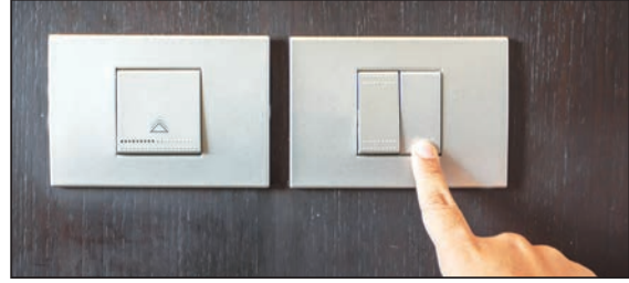
Görsel 2.56: Elektrik anahtarları
